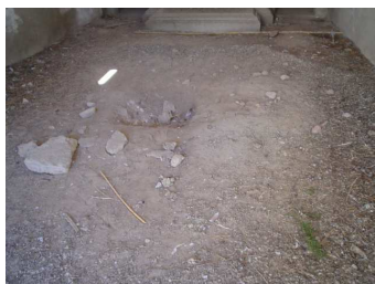
Piso de terrado por perdida total de piso original
