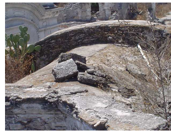
Techumbre de bóveda hecha de piedra caliza con pérdida de impermeabilizante
