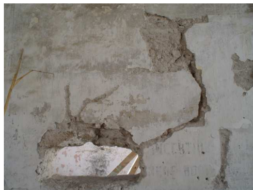
Vista de muro interior de la capilla, con presencia de aplanados y materiales desnudos
