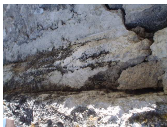
Piedra caliza con presencia de hongos por humedad
