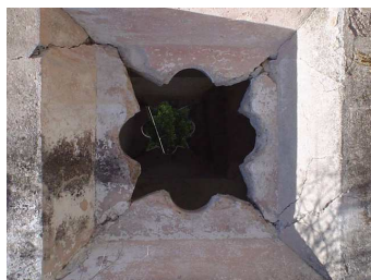
Ventana con perdida de aplanados, falla estructurales y agrietamiento
