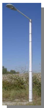
Alumbrado público que se localizo dentro del área del inmueble
