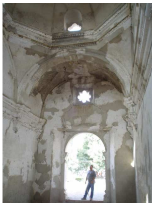
Vista de fachada interior, con muestras de intervención de cemento gris
