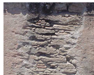
Piedra caliza con desgaste y pérdida de aplanados
