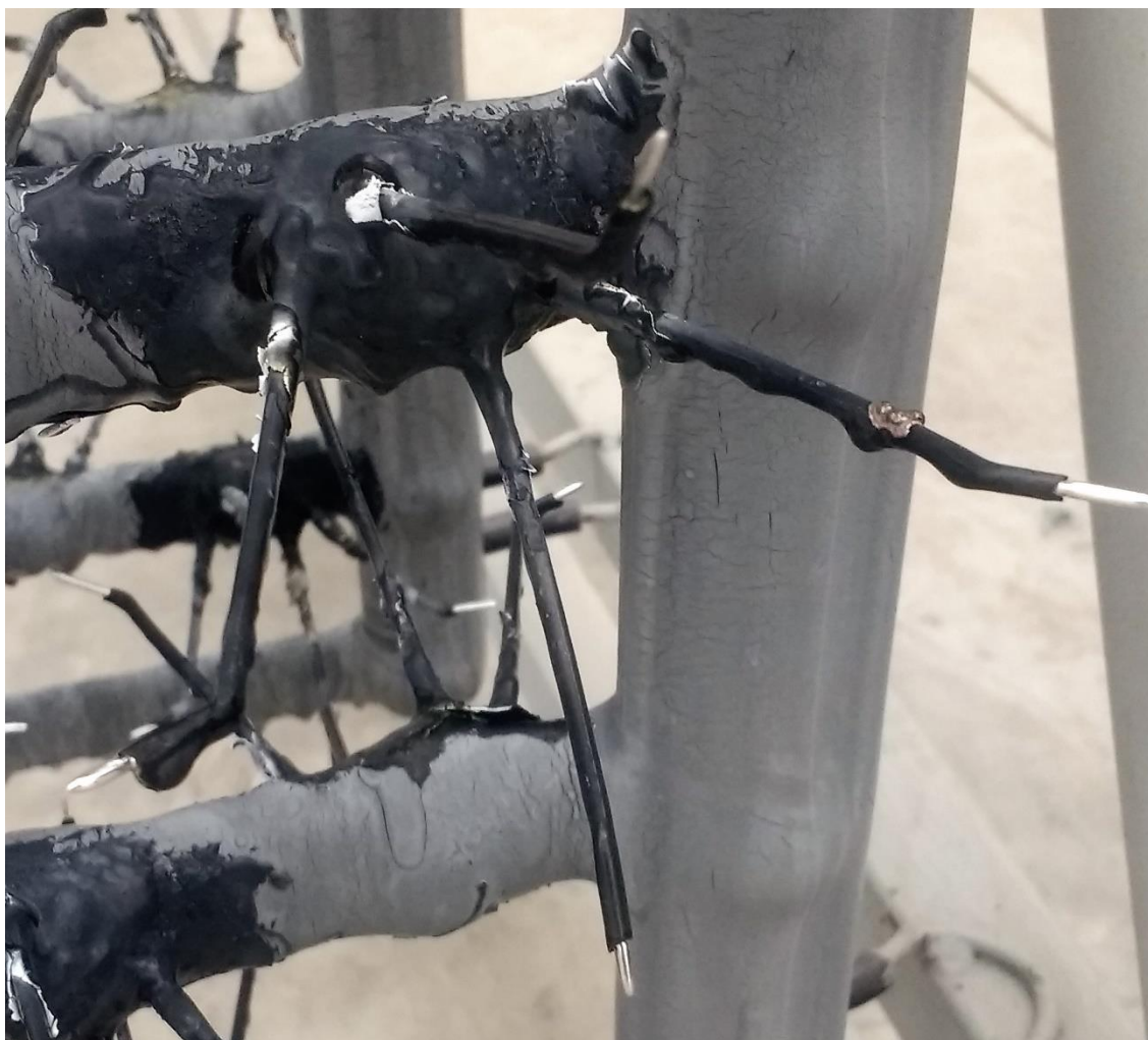
Figura 38 Puntos de contacto / sujeción dañados y plastisol con fisuras que generan corales.
