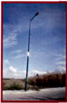
Imagen 44.luminarias en vía ppal.
