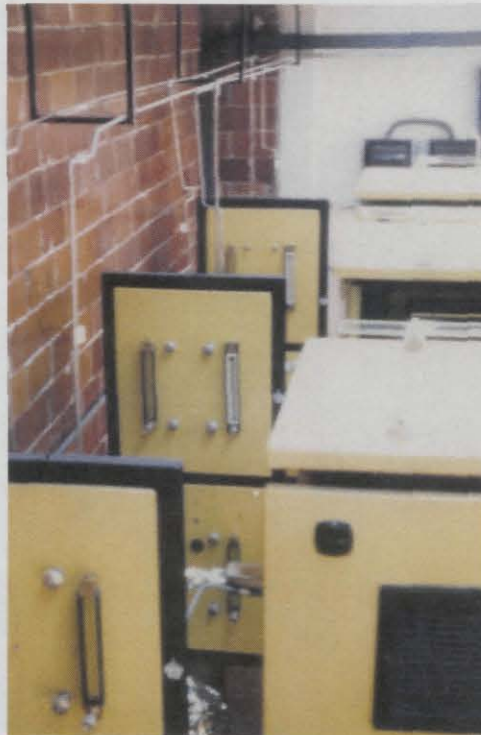
Figura 3. 22, Rotámetros para el control de flujos de gases de alta pureza como: nitrógeno, oxígeno, fosfina y diborano.
