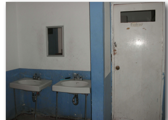
El area de los lavamanos se localizan en un pasillo de la unidad.
