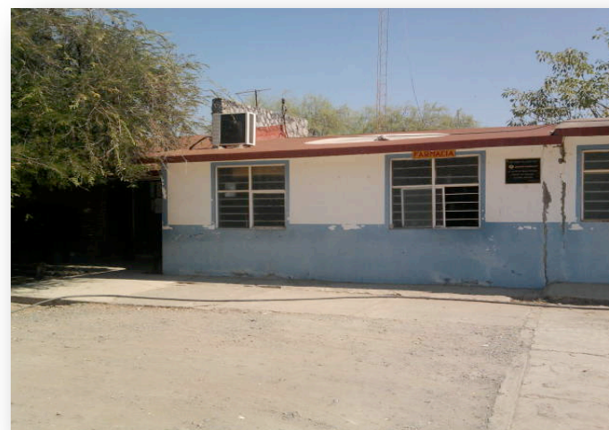
No cuenta con rampas ni firmes adecuados para personas con capacidades diferentes.
