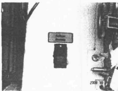
Figura 4.20 Interruptor para activar Bomba
