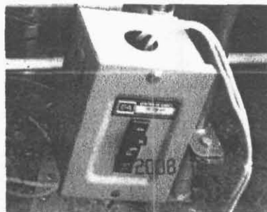
Figura 4.12 Centro de Carga
