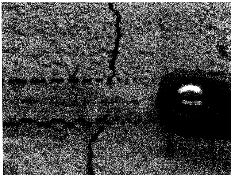
Fig. 3 9 Medición de fisura en el muro 2 a etapa
