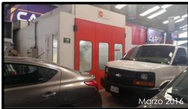
Cámara desmontable de aplicación de pintura para un auto por turno.
