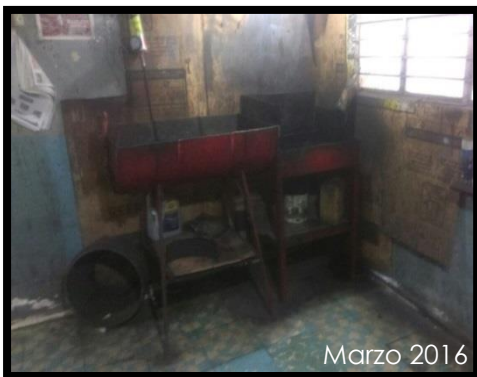
Cuarto de lavado con gasolina sin equipos de seguridad.
