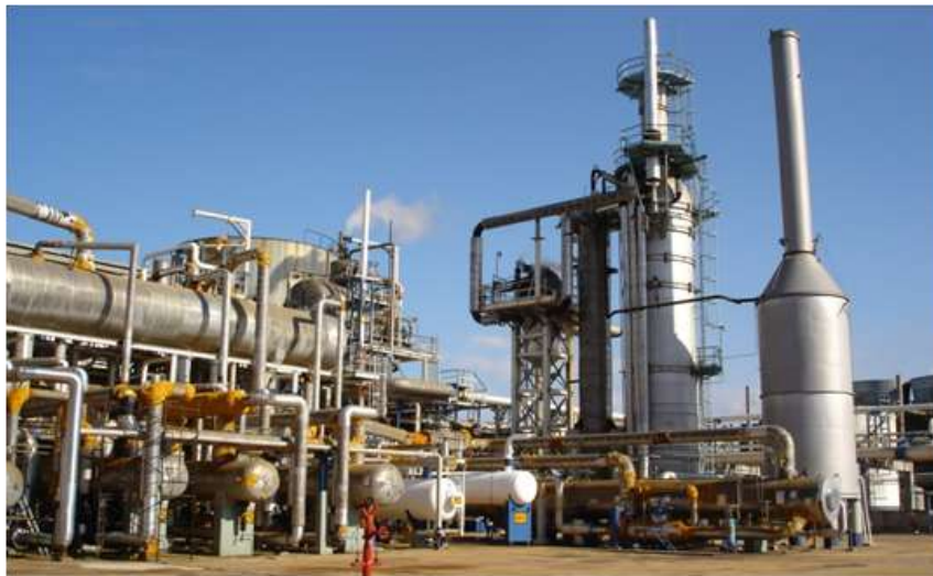
Figura 3.5. Complejo Petroquímico Cosoleacaque. Fuente: Pemex Petroquímica, 2007.
