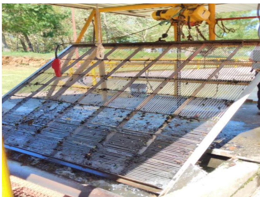
Ilustración 8 Sistema de captación de sólidos. Atexcaco, 2011.
