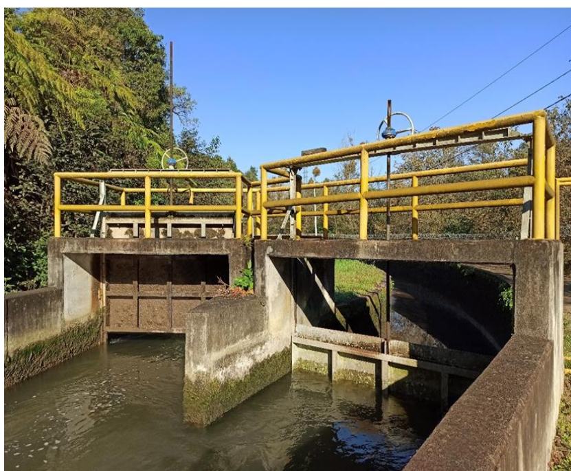
Ilustración 5 Compuertas de entrada al desarenador. Atexcaco, 2021.
