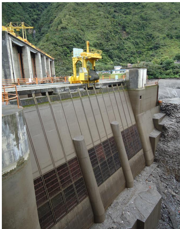
Ilustración 1 Pórtico Limpia rejas y toma de carga de la Central Agoyán (Aldaz, K., Sánchez, P. A., & Torres, J. A. 2018)
