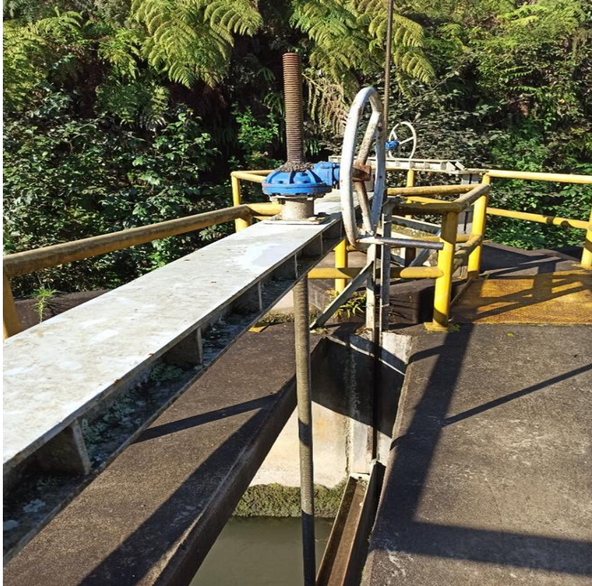
Ilustración 7 Mecanismo de apertura y cierre de las compuertas del desarenador. Atexcaco, 2021.
