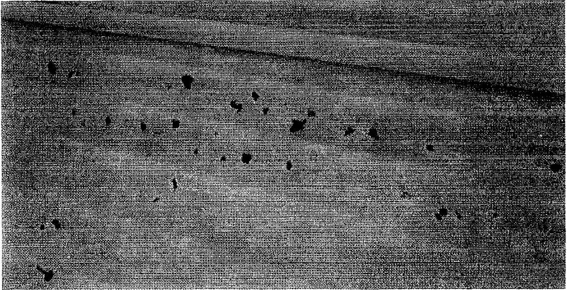
(foto 8 1 15 Lamina perforada por el granizo)
