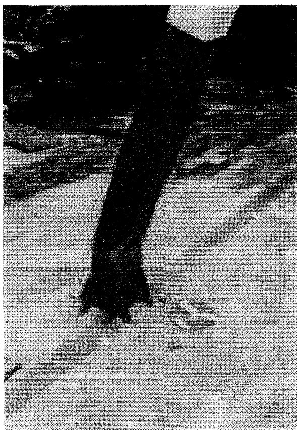
(foto 8 1 8 Falla Estructural en columnas)
