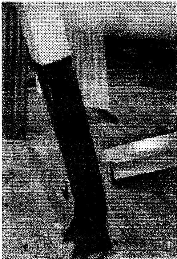
(foto 8 1 7 Falla Estructural en columnas)
