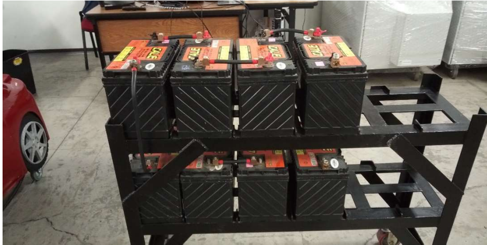
Figura 29. Banco de baterías.
