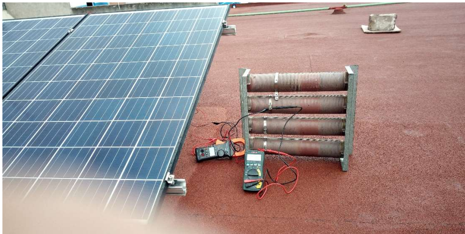
Figura 5. Medición de voltajes y corrientes del panel fotovoltaico.
