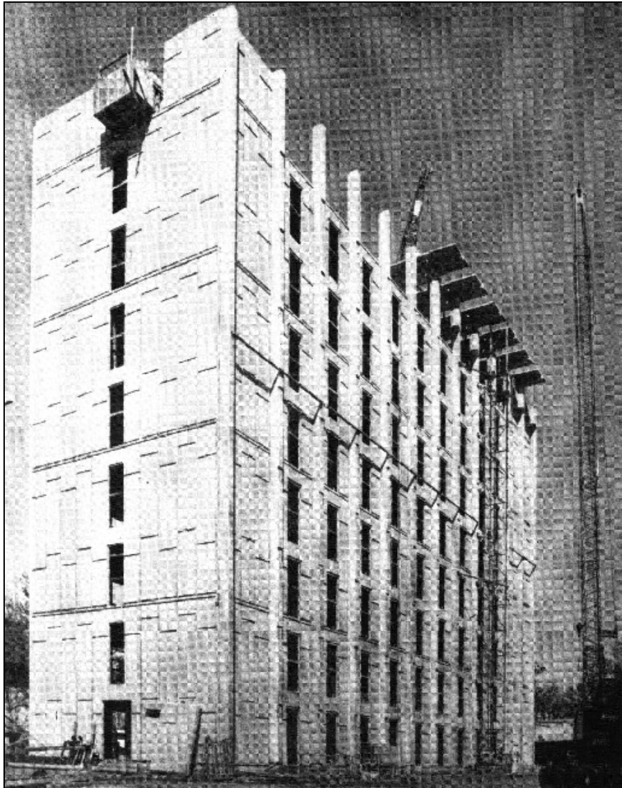
Figura 13.15. Este edificio de nueve pisos fue construido de elementos de concreto de agregados ligeros precolados pretensados, incluyendo columnas, paneles para muros, losas para pisos y cubierta. California, EE.UU.
