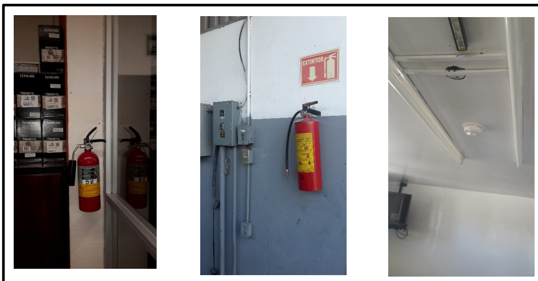
Ilustración 7: EQUIPO VS INCENDIO
