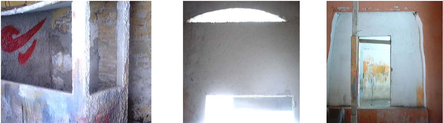
Abajo. AGREGADOS EN EL INTERIOR DE LA FÁBRICA, de izquierda a derecha, Caseta de panel monolite; tapiado de puerta en zona de Talleres; tapiado del acceso a la Administración.
