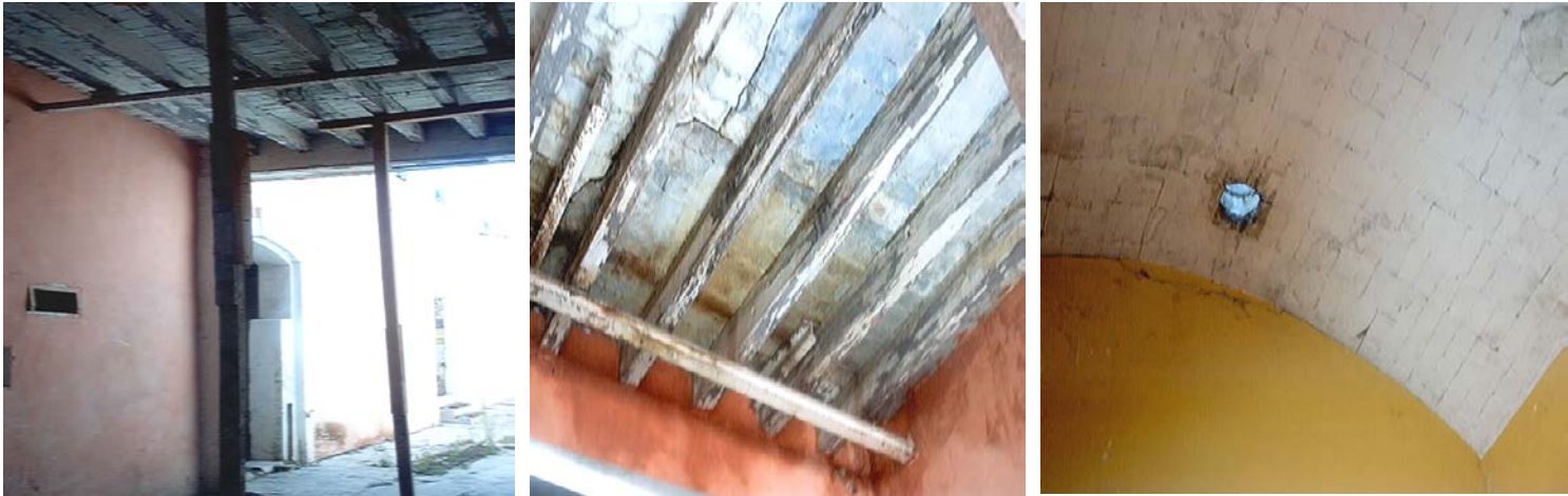
Arriba. ESTADO DE LAS LOSAS, PLANA-DE VIGUERÍA Y TERRADO-, DE MEDIO CAÑÓN-DE TABIQUE-, UBICADAS EN LA ZONA DE ACCESO Y ADMINISTRACIÓN-TALLERES, RESPECTIVAMENTE.
