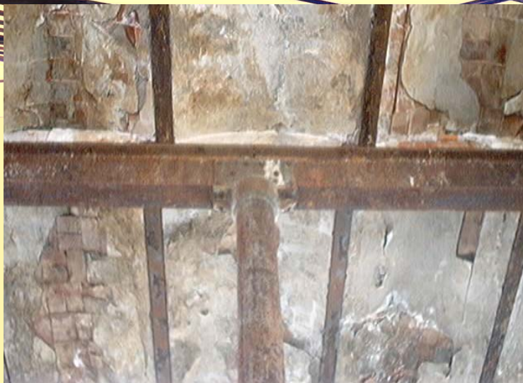
ESTADO DE LA ESTRUCTURA METÁLICA, VIGAS, LARGUEROS Y COLUMNA CON CAPITEL
