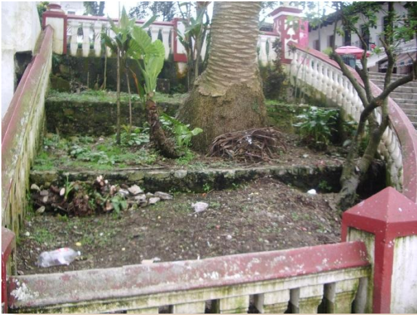
Deterioro en jardinería (F.A.)
