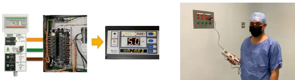
Figura 22. A través del LT-300 se inyecta una corriente igual o mayor a 5mA para asegurarnos que el monitor se alarme, se inyecta la corriente entre L1 y tierra y después para L-2 y tierra.
