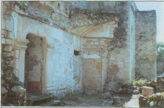
27.- Vistas laterales de la bóveda en ruinas
