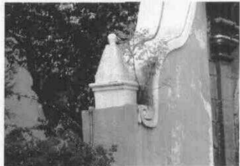
Presencia de parásitos vegetales en portada.
