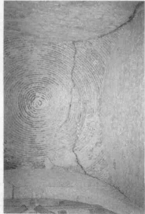
Grietas en Bóveda por cargas excesivas que nunca tuvo.
