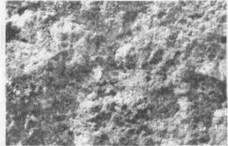
Detalle de líquenes amarillos creciendo sobre fachadas de piedra.
