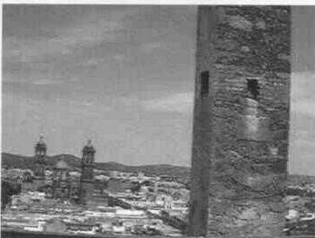
Disgregación de juntas en el muro de piedra.
