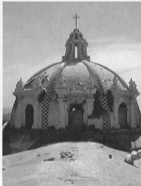
Daños en la Cúpula de San Jerónimo.
