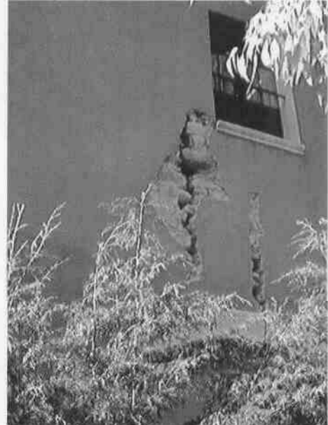
Grieta de lado del Convento sobre la Portería.
