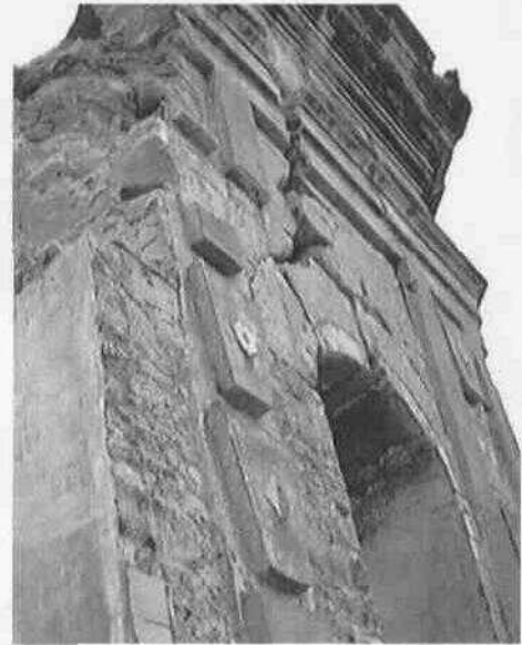
Desprendimiento de aplanados y azulejos.
