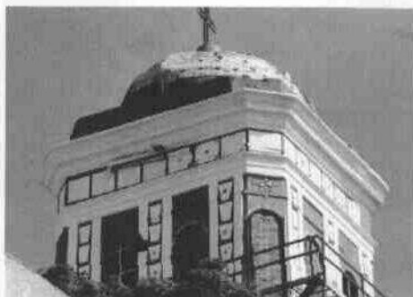
Cimbra de block provisional que debería de ser retirada al terminar los trabajos de reestructuración, mimetizando su presencia con pintura.
