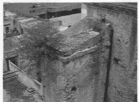
Parasitos vegetales en muros exteriores del Templo.
