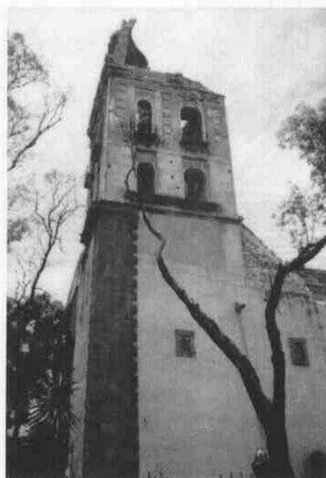
Daños ocasionados al Templo de San Agustín, afectando su valor histórico, estético y material.
