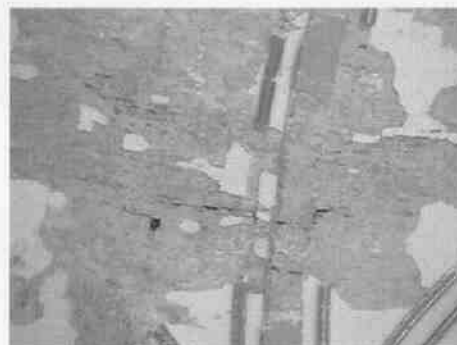
Desprendimiento de aplanado en el interior de la Bóveda.
