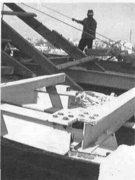
Unión de vigas de acero.
