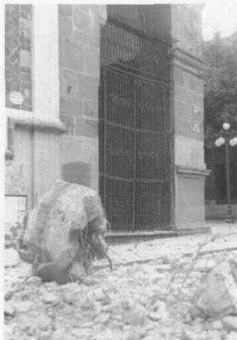
Desprendimientos de remates.
