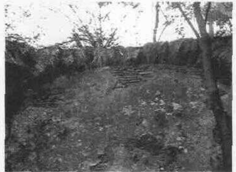
Disgregación de materiales en muros sin techumbre.
