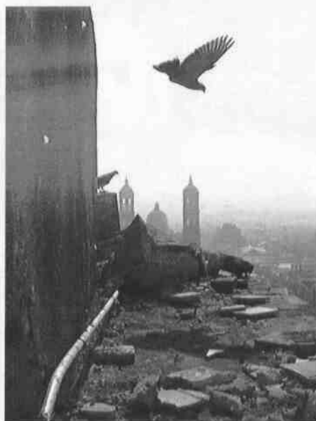
Escombro sobre la cornisa.
