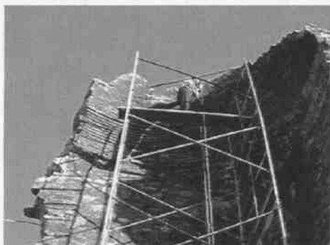
Vista interior de lo que quedó de la cúpula.
