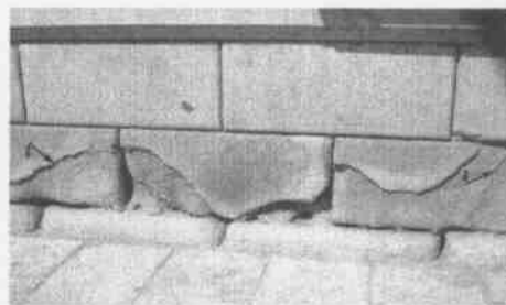
Deterioro de sillares de granito antes de la intervención.
