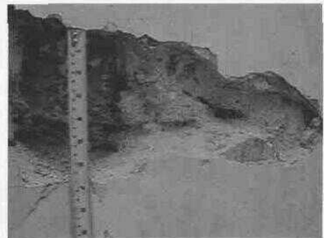
Grietas en muro.
