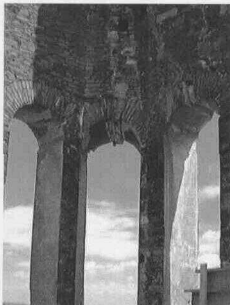
Grietas en el arco del ochavo.
