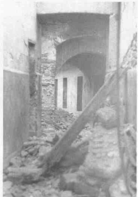
Colapso de Losas.
