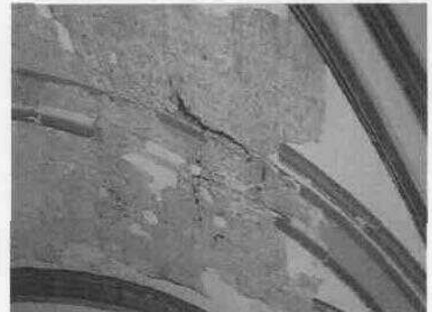
Grieta en el intradós de la Bóveda por el impacto.
