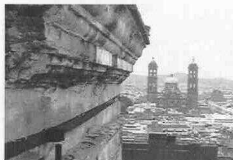
Zuncho metálico colocado con anterioridad debido a problemas de estabilidad de la Torre.
