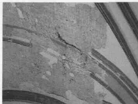
Grietas y fisuras en la nave del Templo.
