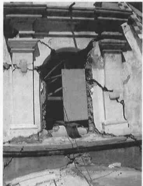
Detalle del daño a la Cúpula de San Jerónimo por el sismo.
