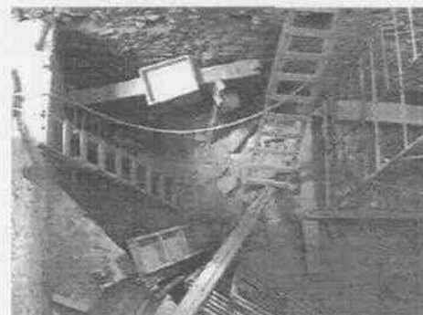
Capilla sobre la que se desplanta la Torre y en donde se alojo excremento de palomas de aproximadamente 2 metros de profundidad
