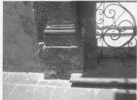
Disgregación de material de Cantera.
