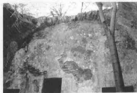
Falta de mantenimiento por indolencia con riesgo de perder el Patrimonio.
