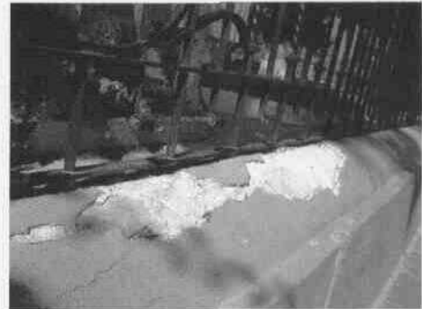
Desprendimiento de aplanado.
