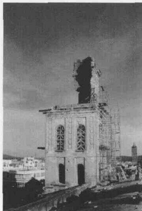
Desprendimientos de aplanados, se acentúan grietas y se desploma gran parte del último cuerpo de la Torre.
