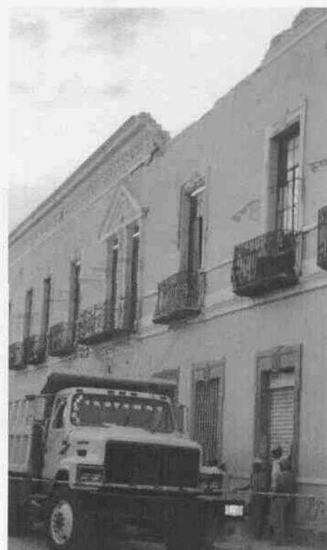
Daños en Cornisas.
