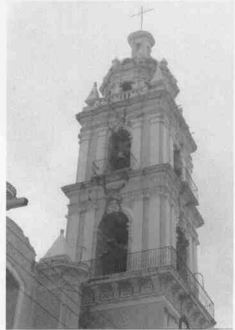
Daños en Torre.
