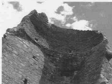
Desprendimiento de aplanados.
