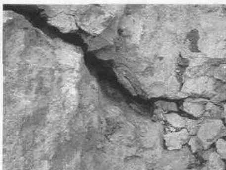
Estructura poco sólida por grandes hoquedades.
