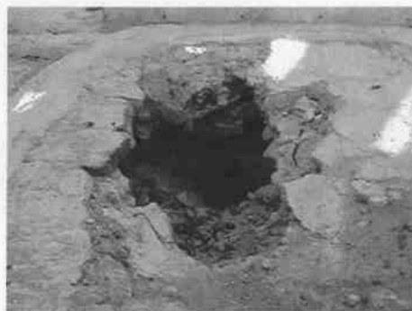
Hoquedad en la Bóveda por el impacto al desplomarse parte de la Torre.
