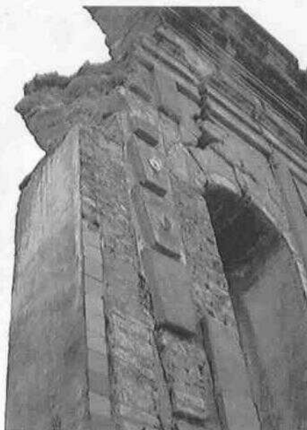
Daños evidentes en el último cuerpo de la Torre.
