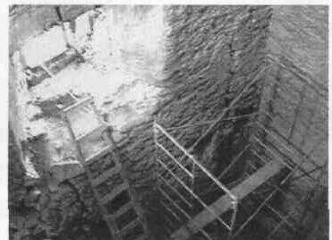
Disgregación de materiales en juntas.
