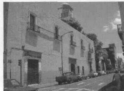
Otro de los deterioros es la apertura de vanos como se observa en lo que fue la Capilla de Santa Rita.
