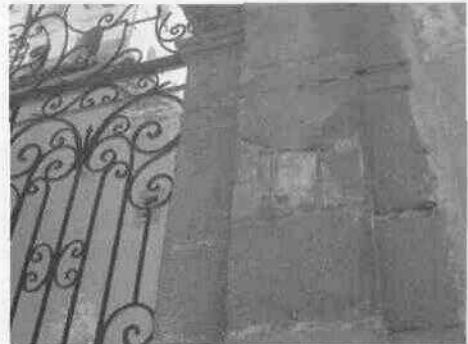
Faltante de material de Cantera.
