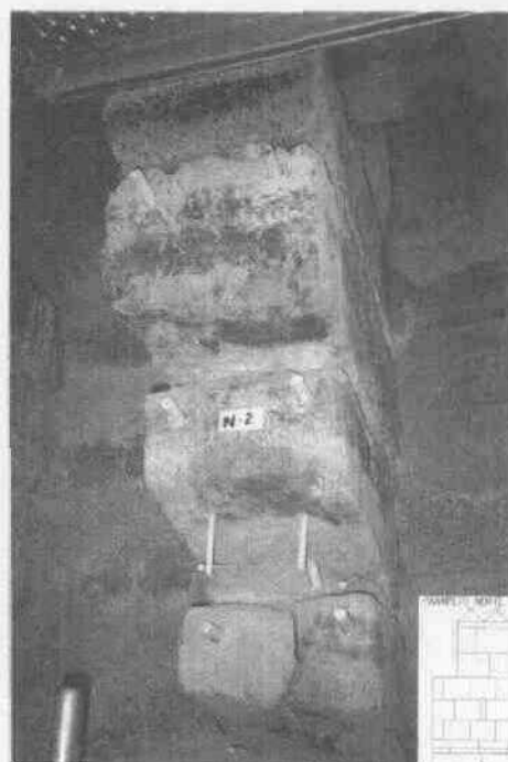
Deterioro de la ménsula antes de la intervención.
