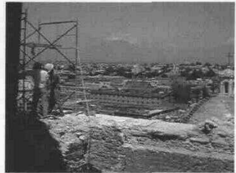
Liberación de escombros sobre las cornisas.
