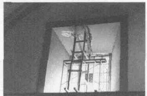
Grieta en ventana del coro lecho superior.
