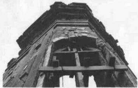
Desplazamiento del ochavo sureste del último cuerpo de la Torre que quedó en pie.
