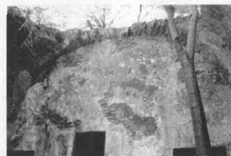
Foto del interior del Convento en destrucción.
