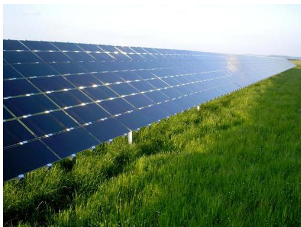
Figura. 2.5 Paneles solares fotovoltaicos de películas delgadas
