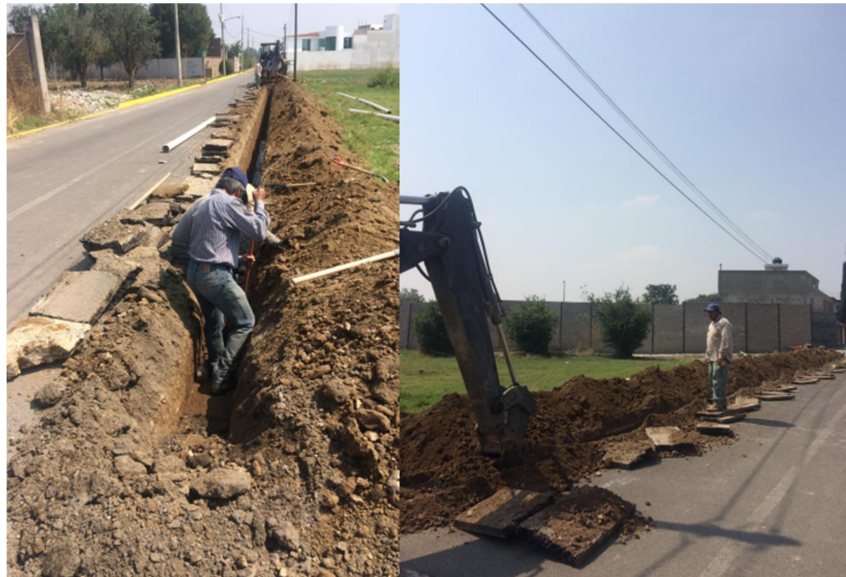
Ilustración 21. Conexiones con red de fraccionamiento ubicado a unos metros. Foto propia.
