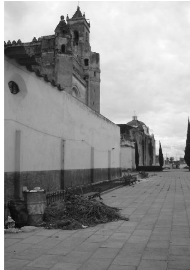
Fotografía actual (marzo de 2004). Convento. Actualmente el piso es de adocreto, la cubierta es de lámina y se observa el aumento del nivel de la barda. Contaminación por basura.
