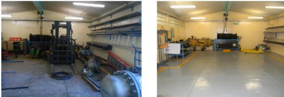
Figura 32. Bodega eléctroinstrumentista antes y después de la implementación de las auditorías 5'S del local No productivo Mantenimiento
