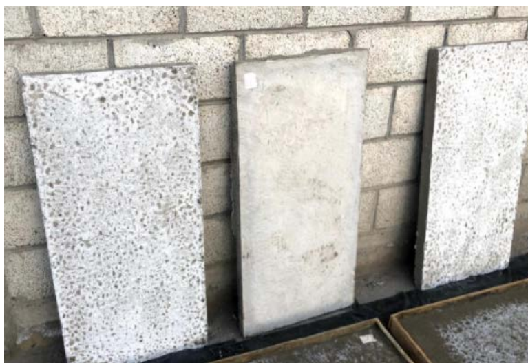
Figura 2.4. Placas de cemento con eflorescencia.
