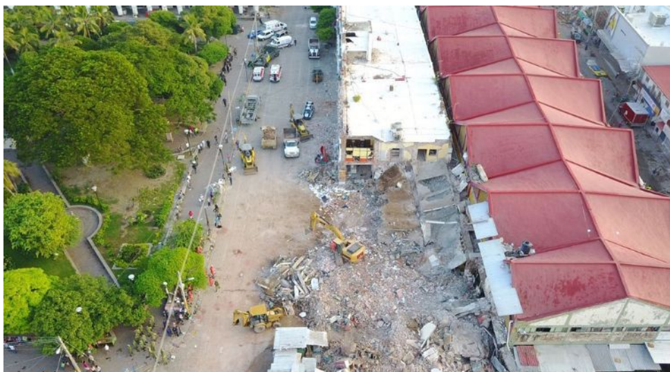
Figura 1.5 Foto del Mercado “5 de Septiembre” de Juchitán de Zaragoza, Oax., tras sismo del 7 de septiembre 2017
