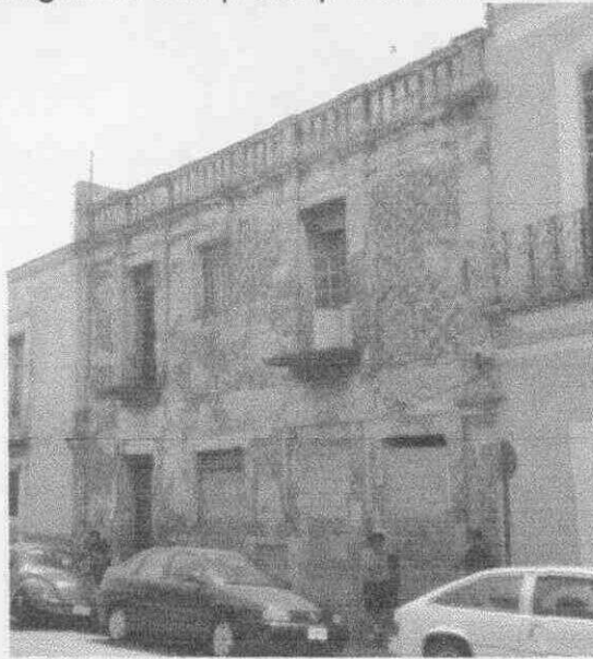
Este grado de deterioro que observamos en este inmueble lo vemos frecuente mente en otros edificios del Centro Histórico.
