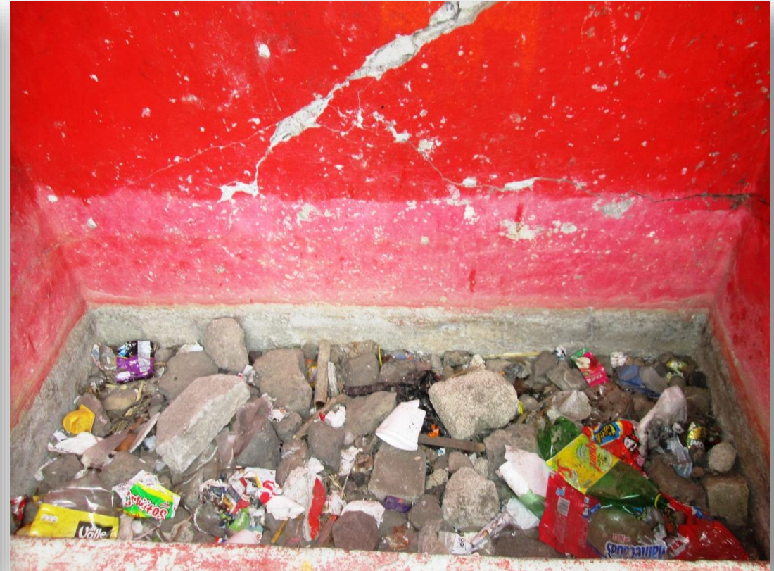
• DEPOSITO – Almacenamiento Mayor
