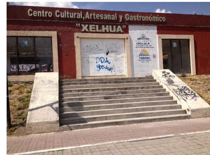
Imagen 11. Fachada principal del centro cultural Xelhua deteriorada por el vandalismo de la zona.
