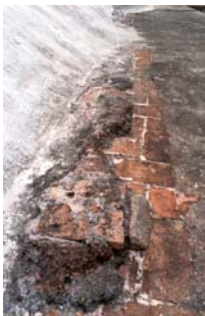
Faltante de piezas en cubierta, en arranque de bóveda de medio cañón, lo que provoca filtraciones de humedad al intrados de la misma cubierta del templo. Afectando también la permanencia de la pintura y los aplanados, así como piezas de madera que se encuentran en el interior.
