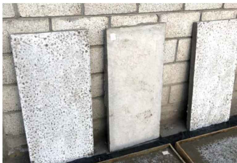
Figura 2.4. Placas de cemento con eflorescencia.
