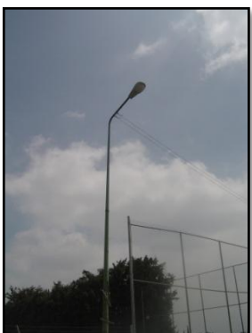
Poste de Alumbrado Publico
