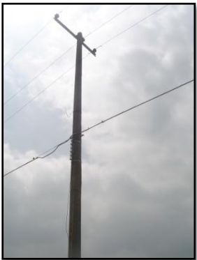
Poste de Energía Eléctrica
