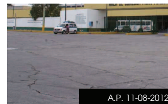
2.48. Se observa el concreto del estacionamiento en mal estado, con grietas.
