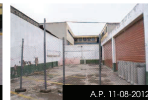
2.49. Se observa un área abandonada que no tiene uso específico.
