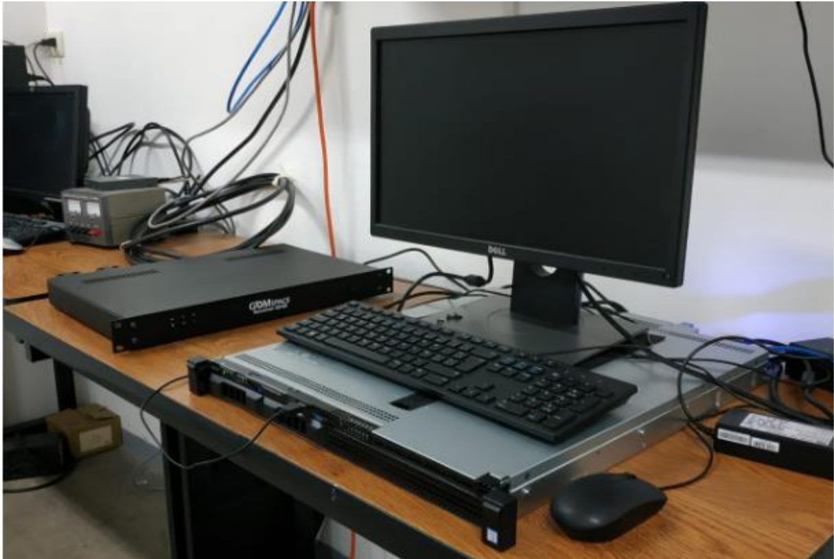
Figura 3.15. Estación Terrena, Módulo Semidúplex.
