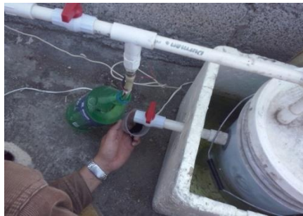
Figura 4.7: Biodigestor en función con prueba piloto Fuente: Propia
