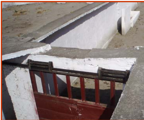
F.27 Fotografía de una de las puertas de acceso a los corrales. A.P.02/2007
