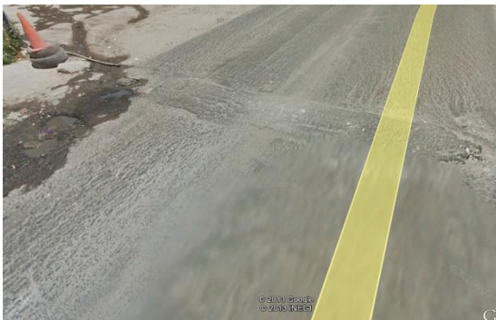
Imagen 85. Mala calidad en el pavimento
