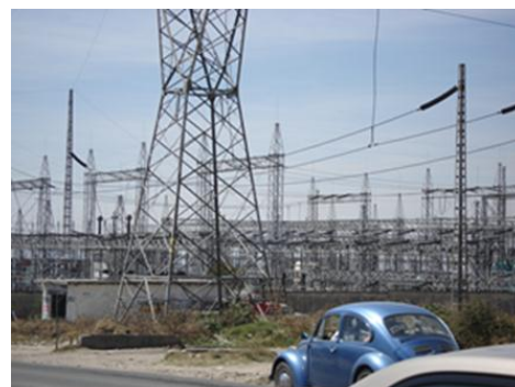
Imagen 15. A.P. Subestación Puebla II y Torres de alta tensión.
