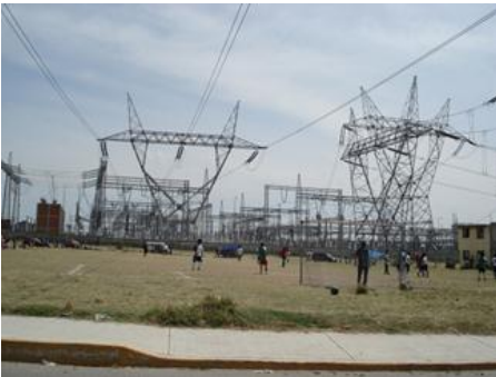
Imagen 04. A.P. los habitantes de la colonia hacen deporte bajo las líneas de alta tensión.
