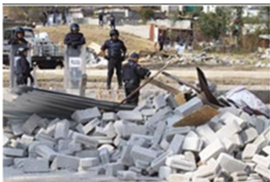
Imagen 125. Mezcla de elementos de construcción sin conciencia
